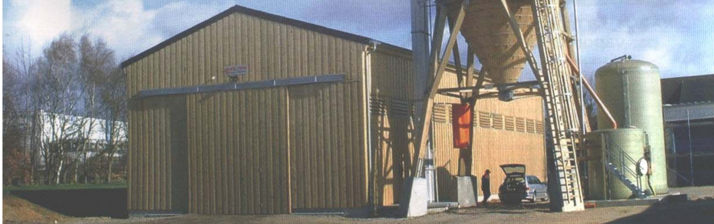
Un hangar de stockage peut servir de stock tampon (par exemple 500 t). Le silo, alimenté directement depuis le hangar par un convoyeur à godet ou pneumatique, stocke la quantité nécessaire de sel pour les interventions à court terme (50 à 100 t).
